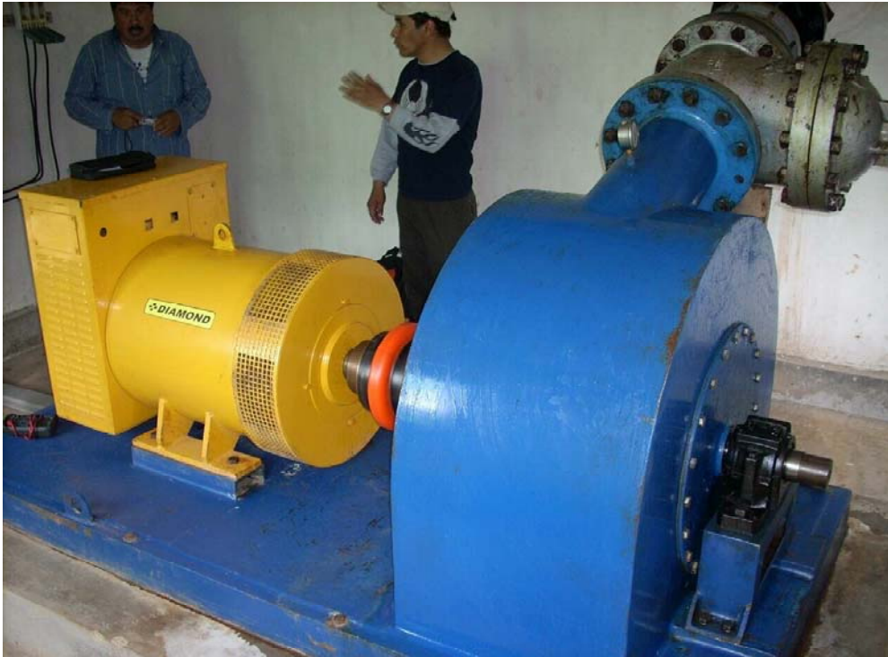
Fotografía 1. Turbina Pelton con generador en la casa de máquinas de la MCH San Juan de Coripata.
