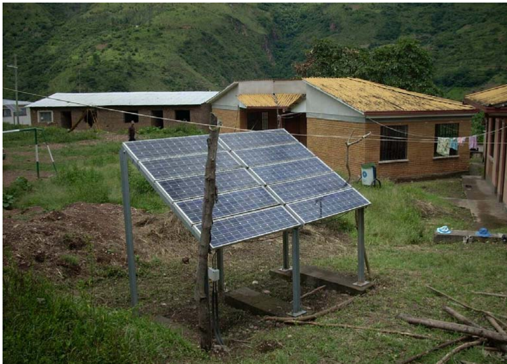
Fotografía 6. Sistema fotovoltaico para la escuela rural en la localidad de San José de Llojeta que ha sido puesto fuera de servicio con la inauguración de la MCH.
